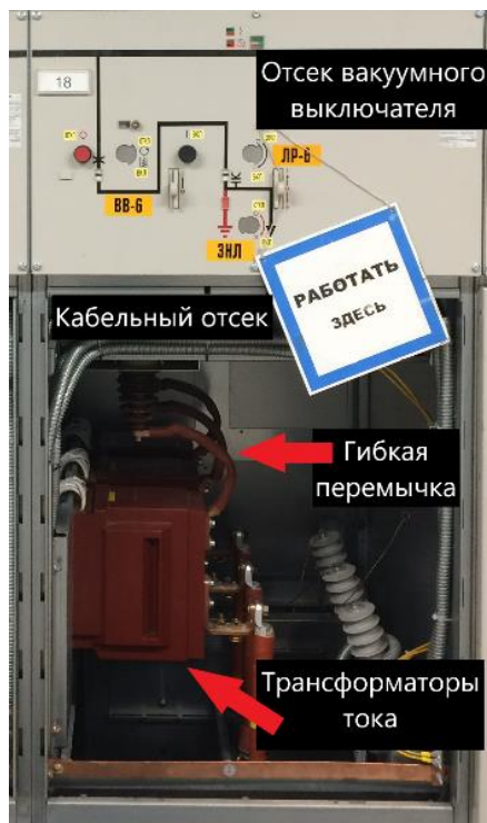
Рис. 1. Ячейка отходящей линии SIEMENS типа SIMOSEC
